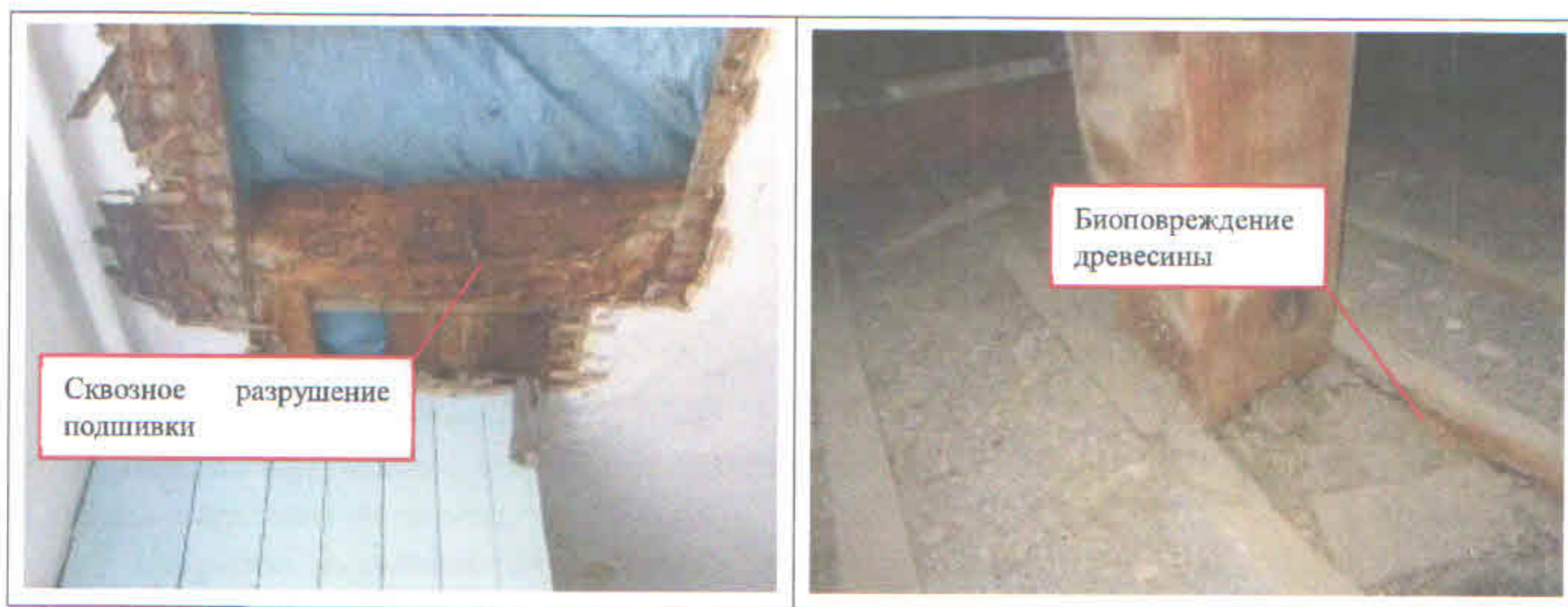
Фото 7 – Общий вид разрушения перекрытия в осях В-Г/8-9
