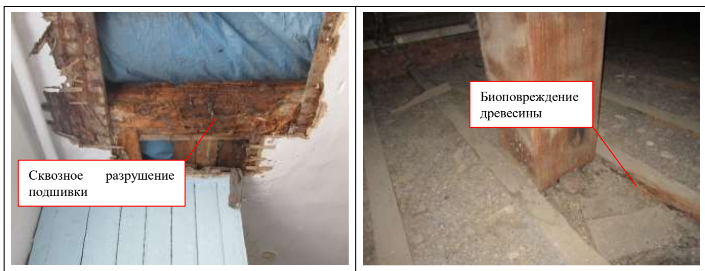
Фото 7 – Общий вид разрушения перекрытия в осях В-Г/8-9
